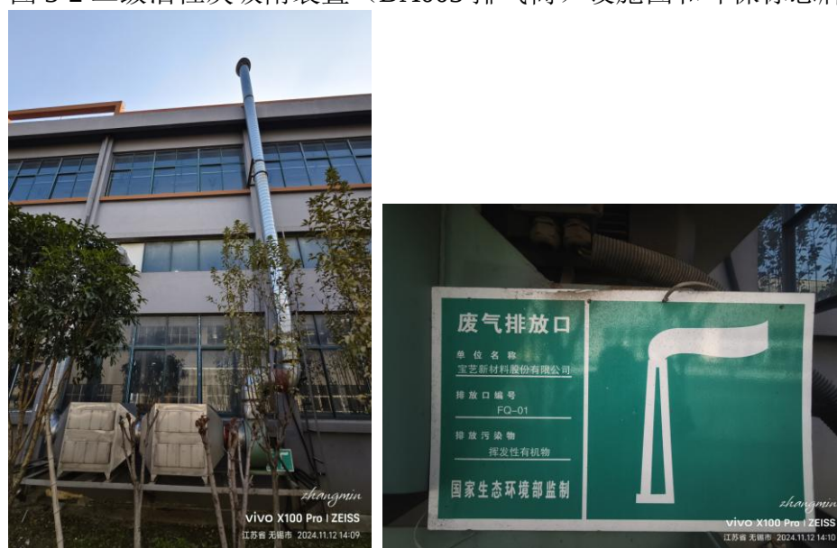
图 3-3 二级活性炭吸附装置（DA001 排气筒）设施图和环保标志牌
