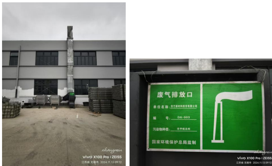
图 3-2 二级活性炭吸附装置（DA003 排气筒）设施图和环保标志牌
