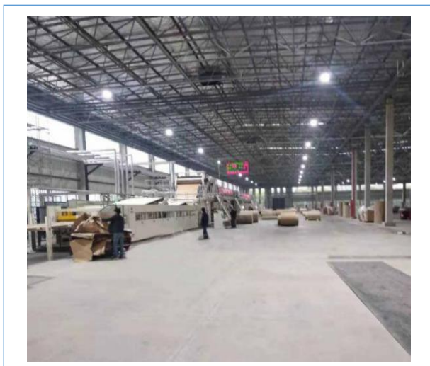
2019年5月，新型包装材料技改项目-5#车间完成基建，新增 BHS 瓦楞生产线安装调试成功；11月，完成 BHS 恒速之星瓦楞生产线、两层片生产线的搬迁、调试工作。
